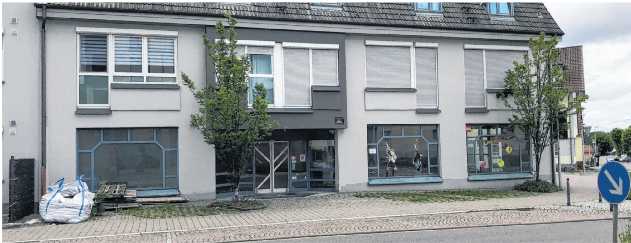
Am Neubau Heidelbergstraße 3 (links) wird noch an der Außenanlage gearbeitet, das Erdgeschoss Heidelbergstraße 5 (rechts) wird in Büro und Wohnung umgebaut. Foto: privat
